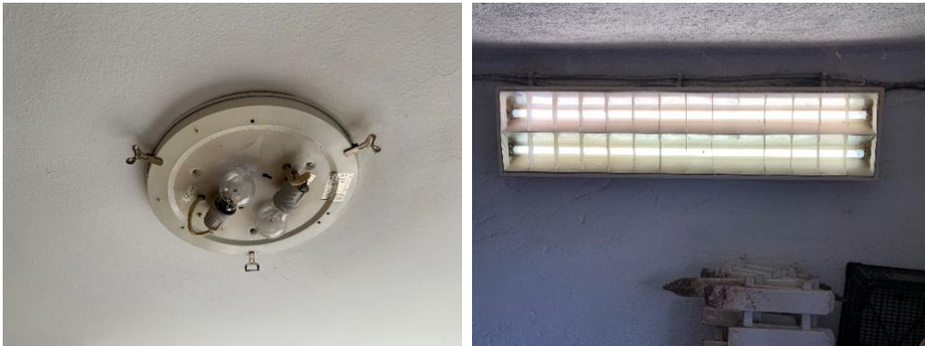
Slika 17: Prikaz rasvjetnih tijela u objektu
