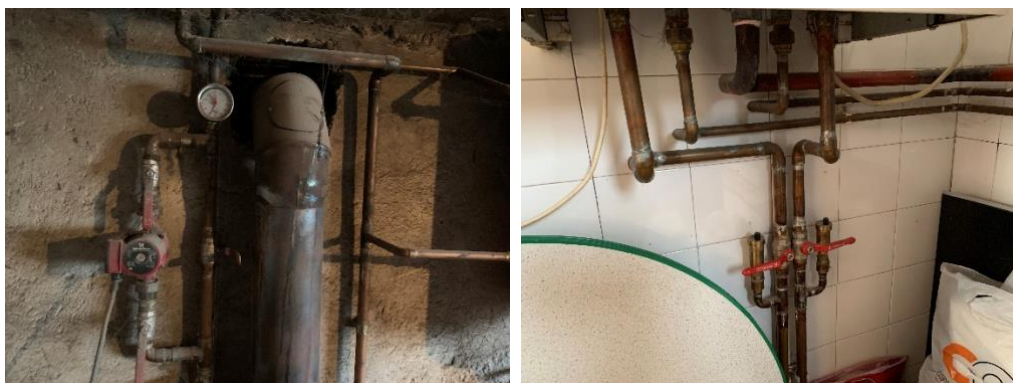
Slika 15: Dio cijevne mreže u kotlovnici (lijevo) i dio cijevne mreže u objektu (desno)
