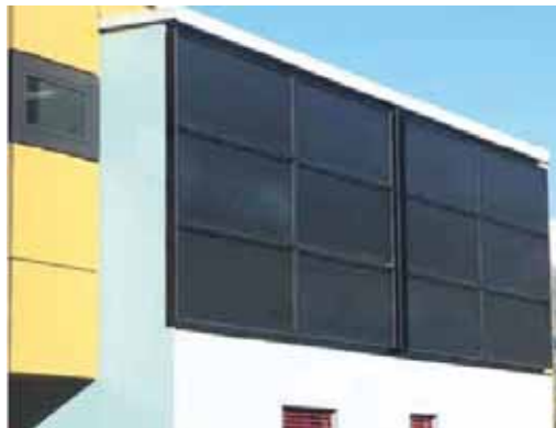
Slika 9.3: Kolektori montirani na fasadi
