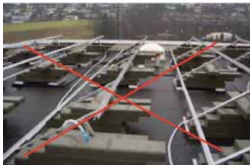
Slika 5.36: Nepravilno balansiranje. Raspodjela opterećenja ne odgovara zahtjevima po normi SIA 261 i 271. Opterećenje vjetrom je veće u području ivice krova nego na sredini krova, što se uvijek odrazi na raspodjelu balasta koji se primjenjuje
