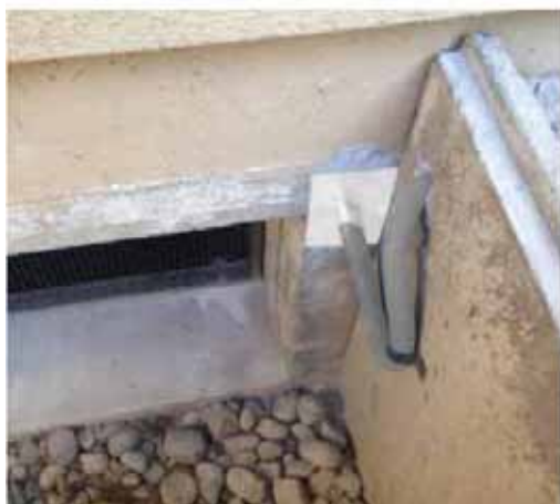
Slike 6.43 i 6.44: Solarni kabl pvi uvedeni u zgradu kroz šaht za rasvjetu
