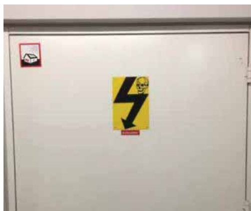
Slika 11.38: Naljepnica upozorenja Pažnja FN sistem u objektu i prilazima
