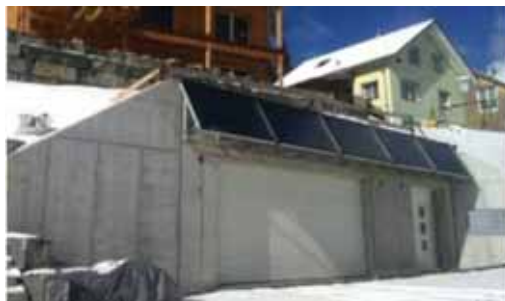
Slika 5.54: Kolektori montirani sa zidnim konzolama na nadkrovlju
