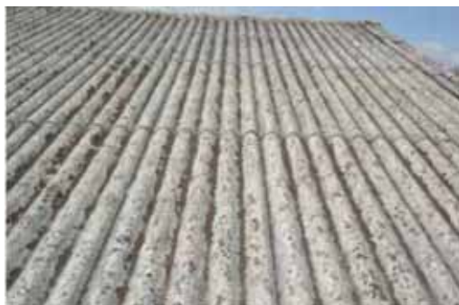
Slika 4.9: Krovovi od cementnih vlakana (azbesta) (trapezasti ili ravni) koje su se proizvodile prije 1995. se moraju provjeriti na sadržaj azbesta
