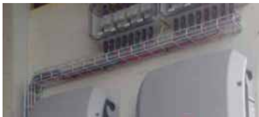
Slika 6.14: Otvoreni mrežni kablovski kanal, u zgradi
