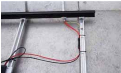
Slika 6.20: Kabl pričvršćeno na šinu s kablovskim vezicama
