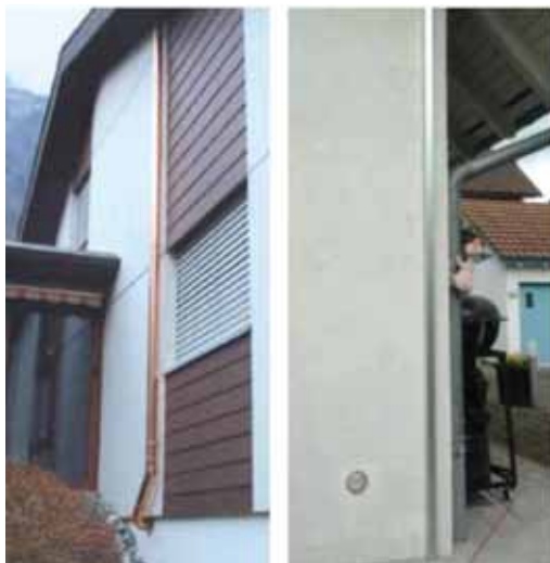
Slike 6.24 i 6.25: Kolektorski solarni vod postavljen u posebnu odvodnu cijev na fasadi, FN vodovi su na fasadi u kanalu od aluminija
