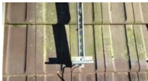
Slika 4.7: Zaprljanje pokrovnog materijala ispod FN sistema, već nakon nekoliko godina, vodi do bržeg starenja
