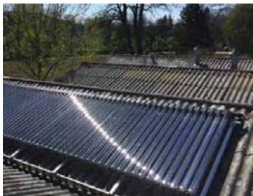
Slika 7.7: Vakuumski - cijevni kolektor na krovu
