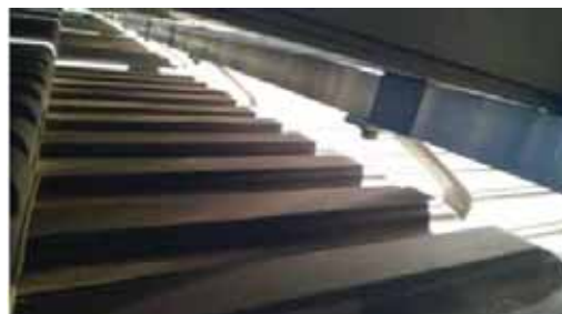
Slika 7.3: Pogled ispod kolektora: na krovnu kuku je pričvršćena montažna šina za držač radi montaže kolektora
