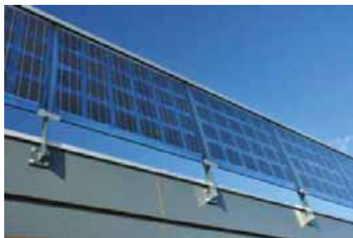
Slika 10.1: FN sistem kao balkonski parapet
