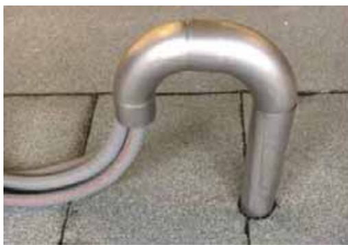
Slika 6.39: Proboj na krovu s limenim spojem sa bitumenskom hidroizolacijom i lukom na vrhu
