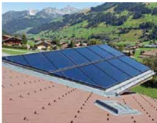
Slika 7.11: Kolektor velike površine. Na slici je jedva vidljivo da su samo dva kolektora.
