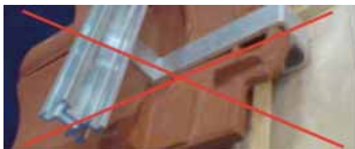
Slika 5.13: Nepropisno postavljena kuka je samo nakačena na vrh crijeva. Opterećenja od snijega se prenose na crijep. Vjetar i vrtlog mogu podići cijeli sistem.
