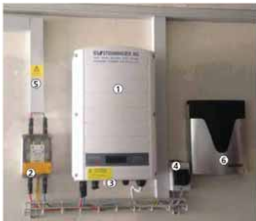
Slika 11.34: FN instalacija sa svim dijelovima za zaštitu, upozorenje i odvajanje
