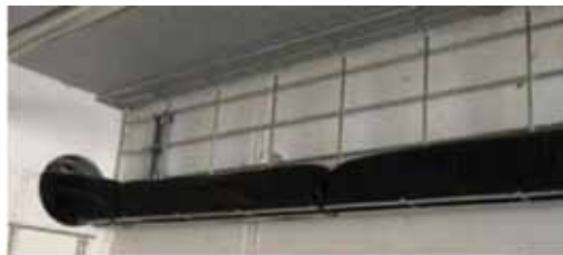
Slika 6.15: Toplinski cjevovod doveden u kanal sa žičanom mrežom
