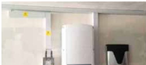
Slika 6.13: Pokriveni PVC kanal za unutrašnje kablove
