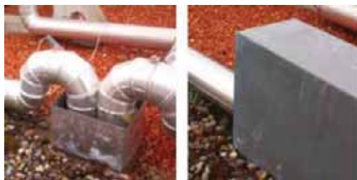
Slika 6.40 i 6.41: Solarni vod se dovodi u zgradu kroz otvoreni gornji okvir (lijeva slika) i prekriven poklopcem (desna slika)
