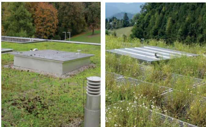
Slika 158: Zeleni krov, lijevo : prije gradnje FN sistema, desno : godinu nakon gradnje, Samuel Summermatter, BE Netz AG
