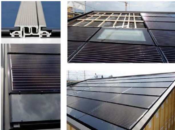
Slika 149: Paneli kao krovni elementi, Samuel Summermatter, BE Netz AG
