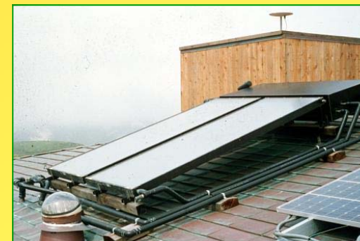
Slika 2. Instalirani solarni kolektor
