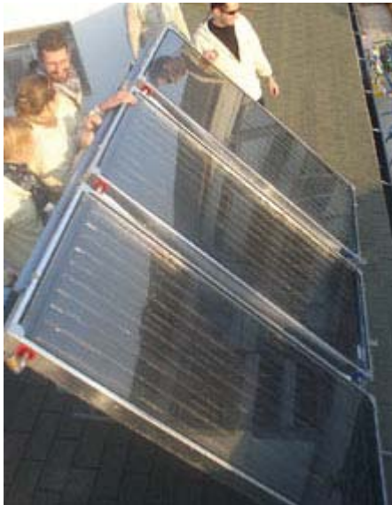
Slika 3.30. Montirani solarni paneli
