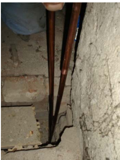
Slika 5.18. Cijevi provedene po dimnjaku
