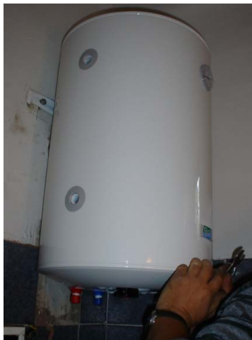
Slika 5.19. Kobinirani bojler za toplu vodu
