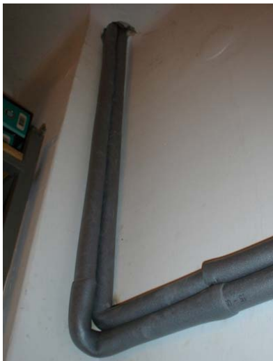
Slika 5.33. Izolacija savršeno prijanja za cijevi
