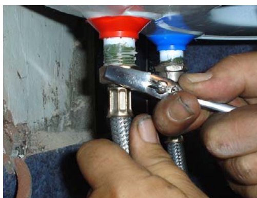
Slika 5.20. Spajanje bojlera na vodovodne cijevi
